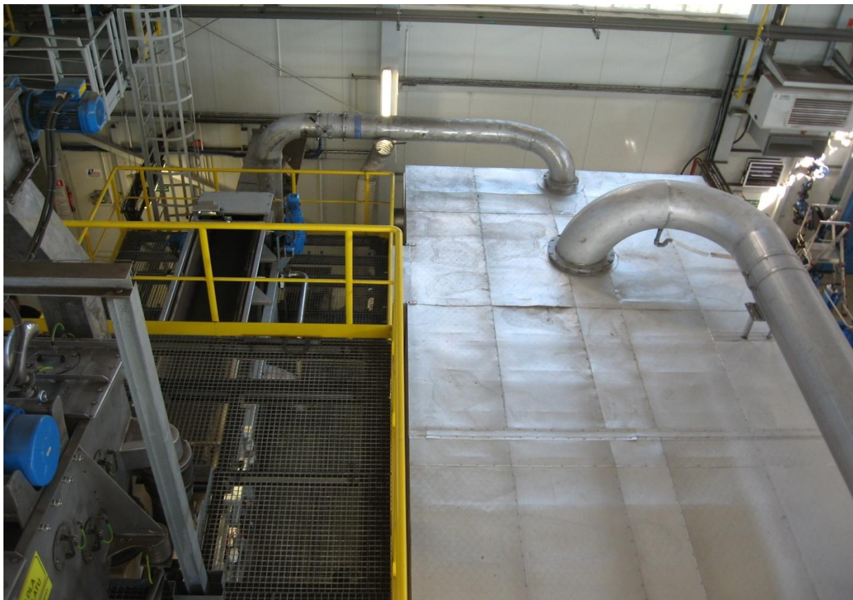
Korpus taśmowej suszarni osadu, chłodnica osadu wysuszonego
