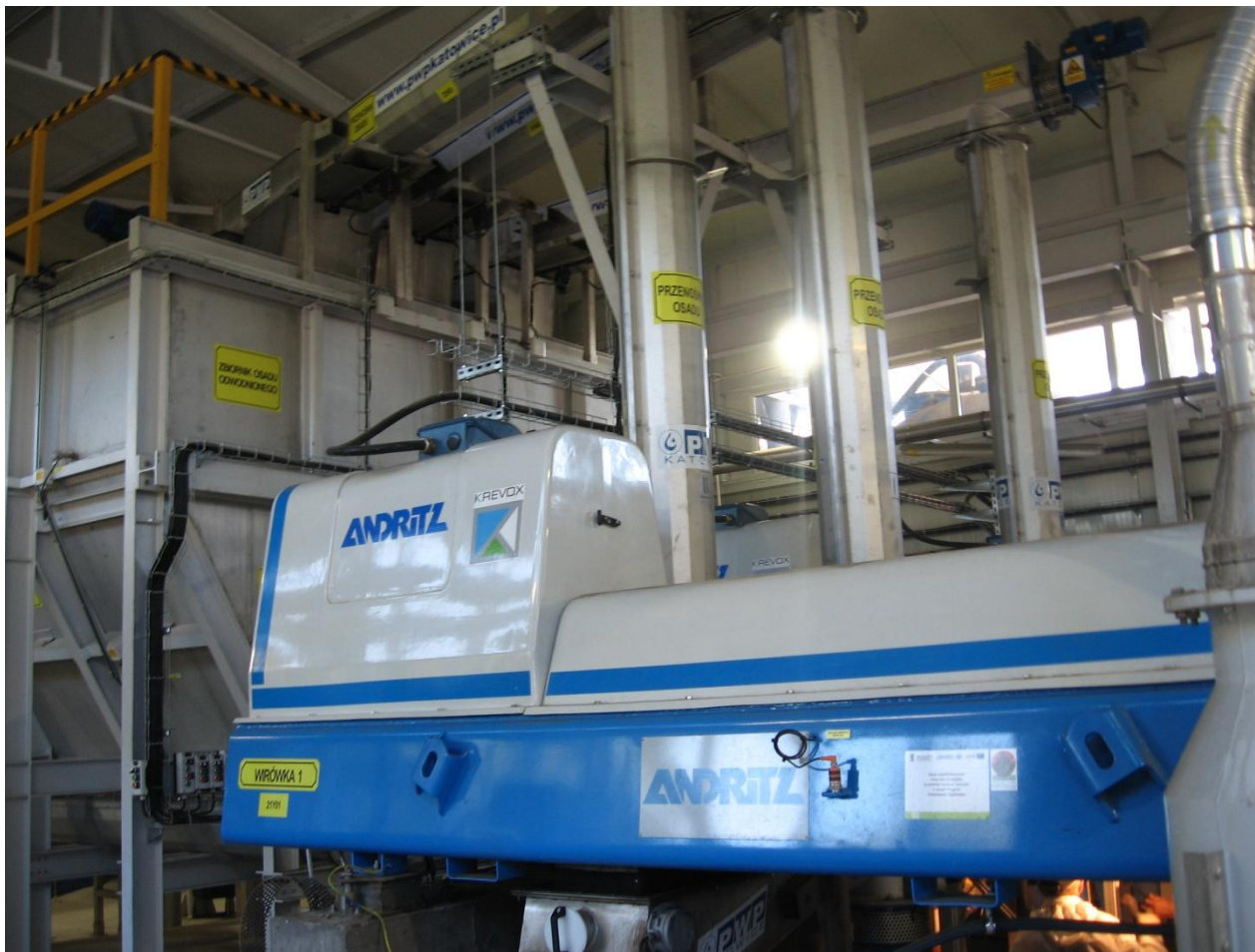
Budynek SMOO wirówki dekantacyjnej, zbiornik osadu odwodnionego, przenośniki osadu odwodnionego
