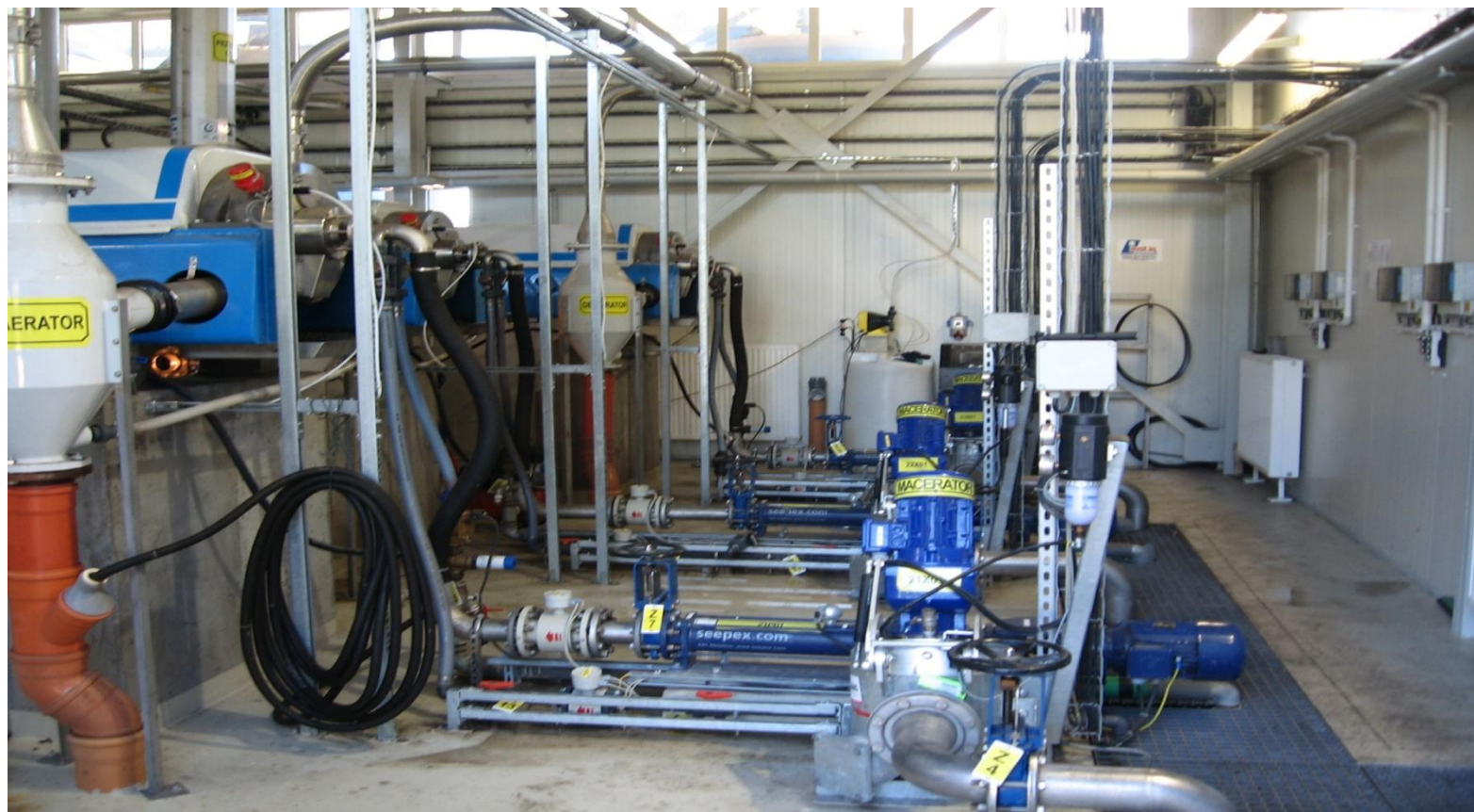
Pompy osadu przefermentowanego i maceratory, wirówki dekantacyjne
