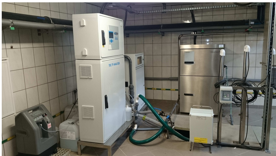
Rys. nr 4. Stacja monitoringu ścieków surowych.
