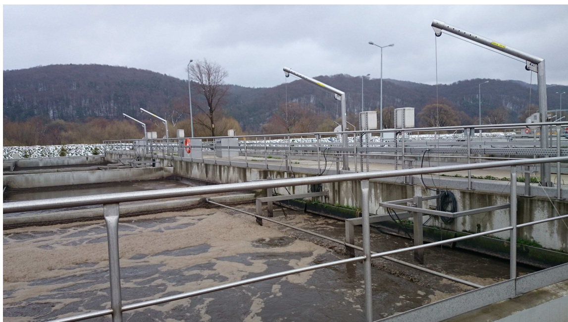
Rys. nr 3. Widok na reaktory biologiczne.
