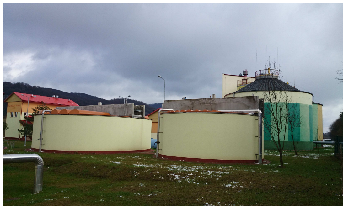
Rys. nr 6. Przedstawia widok na zagęszczacze osadu i komory fermentacyjne.
