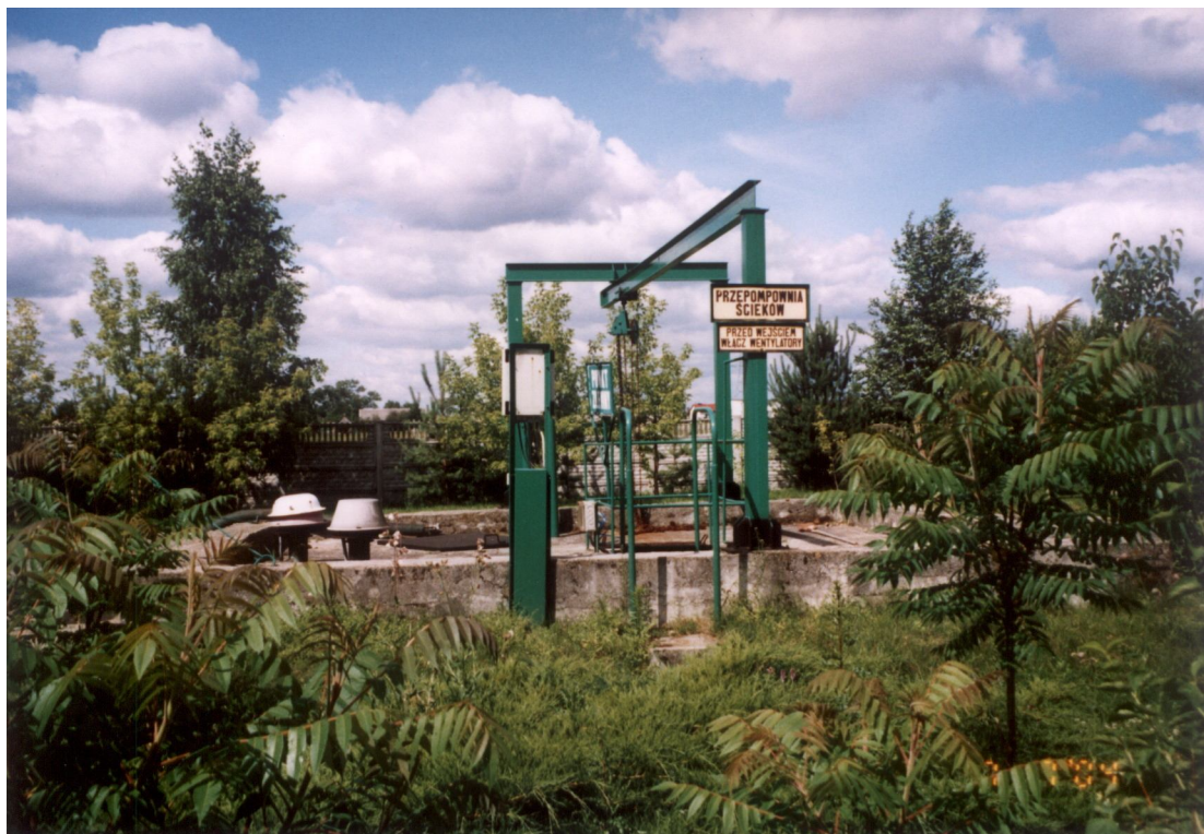
Fot. 3. Widok na główną przepompownię ścieków, Oczyszczalnia Ścieków w Długiej Kościelnej, sierpień 2004 r.
