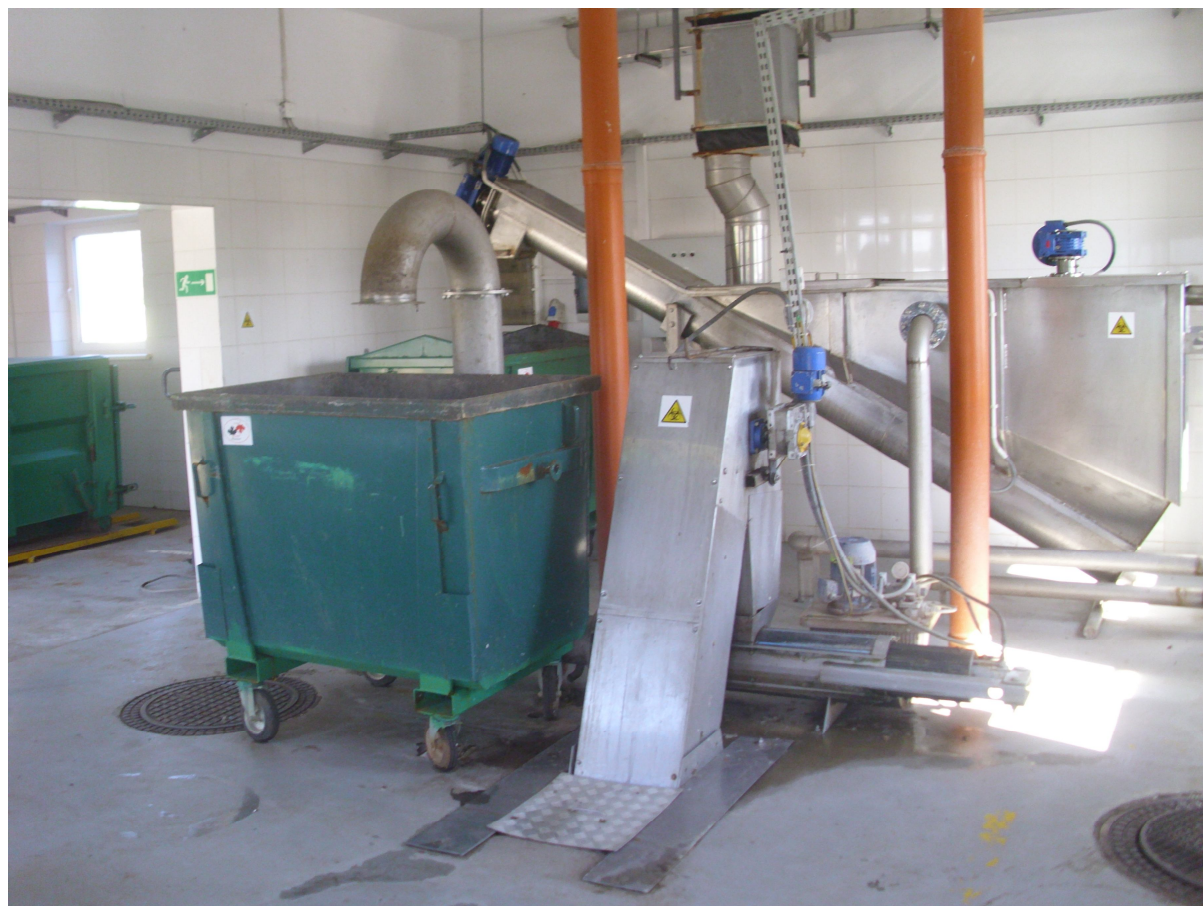
Fot. 12. Widok na piaskownik i kratę gęstą (część naziemna) Oczyszczalnia Ścieków w Długiej Kościelnej, marzec 2014 roku.
