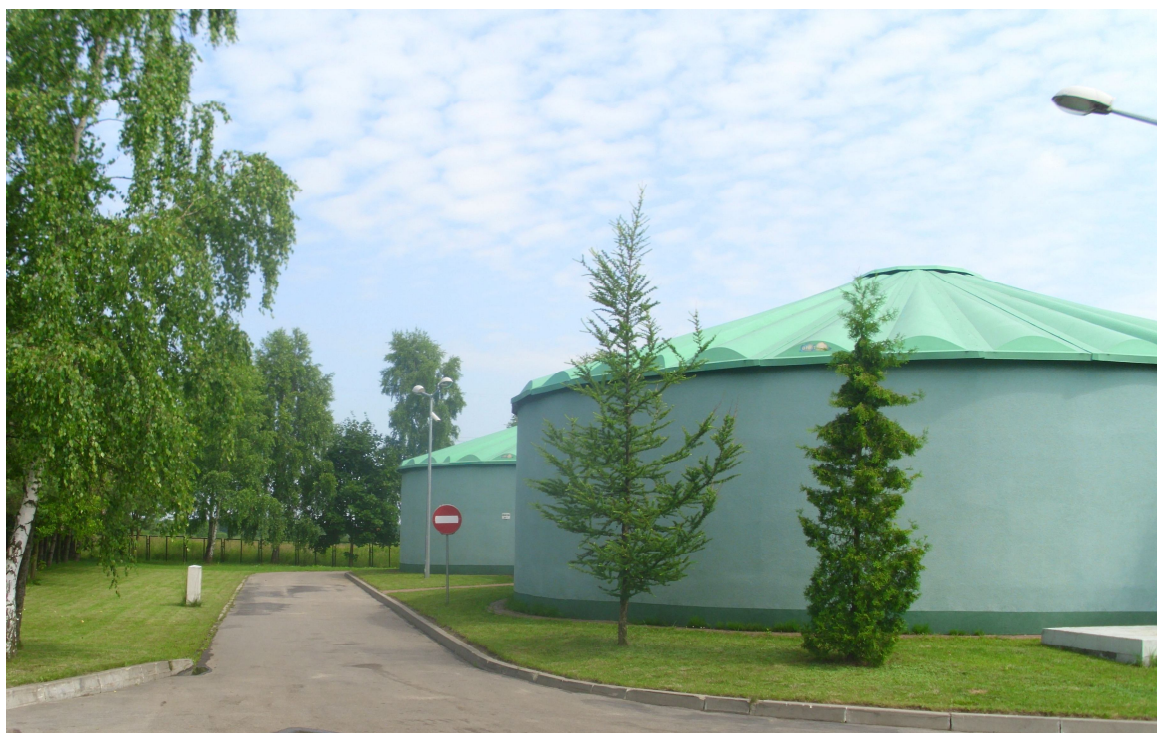
Fot. 14. Bioreaktory Oczyszczalnia Ścieków w Długiej Kościelnej, czerwiec 2013 roku.
