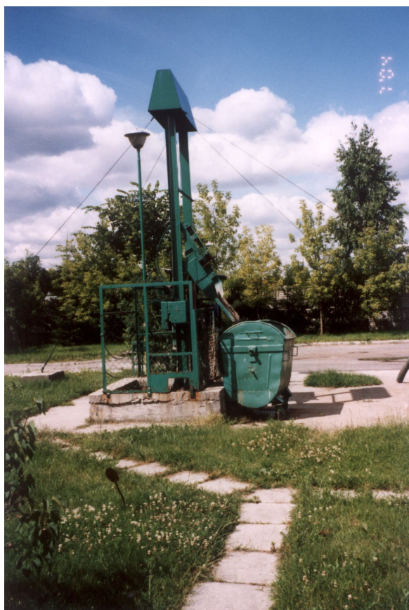
Fot. 2. Widok na kratę koszową, oraz pojemnik na skratki, Oczyszczalnia Ścieków w Długiej Kościelnej, sierpień 2004 r.
