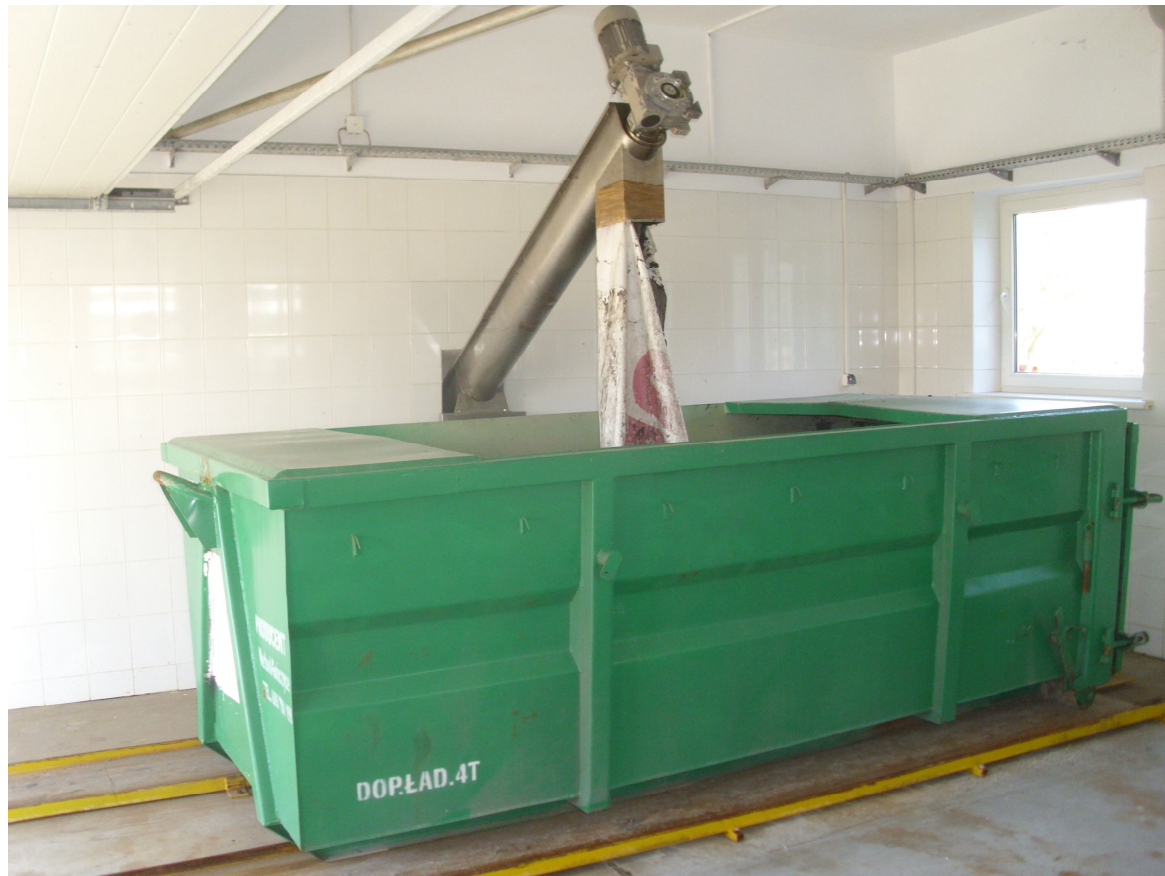
Fot. 16. Prasa taśmowa, widok na podajnik – zrzut do kontenera marzec 2014 roku.
