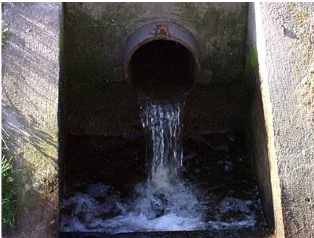
Fot. 19. Spust ścieków oczyszczonych, Oczyszczalnia Ścieków w Długiej Kościelnej.
