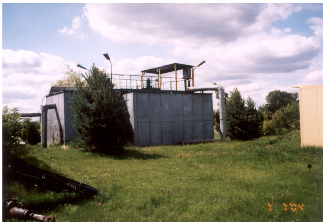
Fot. 6. Widok na zbiornik Bioblok MU – 100 na osad nadmierny, Oczyszczalnia Ścieków w Długiej Kościelnej, sierpień 2004 r.
