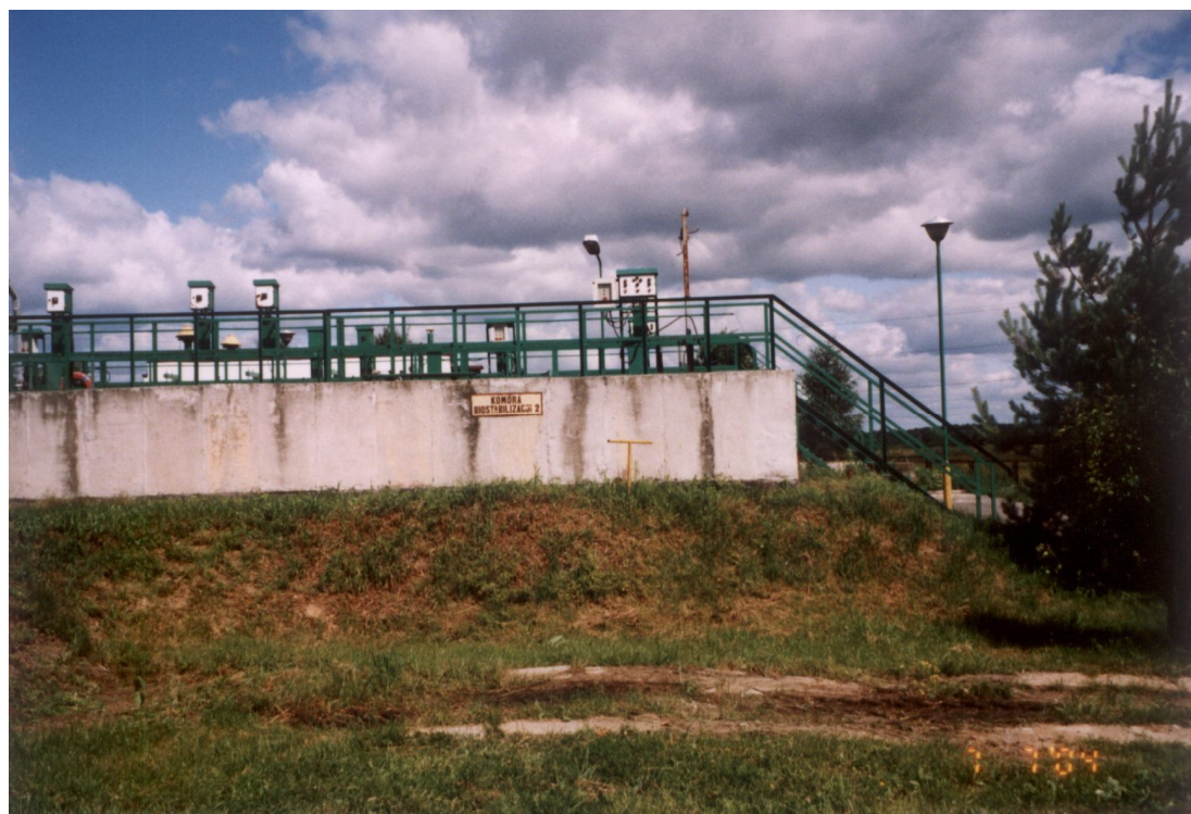
Fot. 5. Widok na komorę biostabilizacji, Oczyszczalnia Ścieków w Długiej Kościelnej, sierpień 2004 r.
