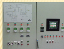
DRZWICZKI SZAFY STEROWNICZEJ
