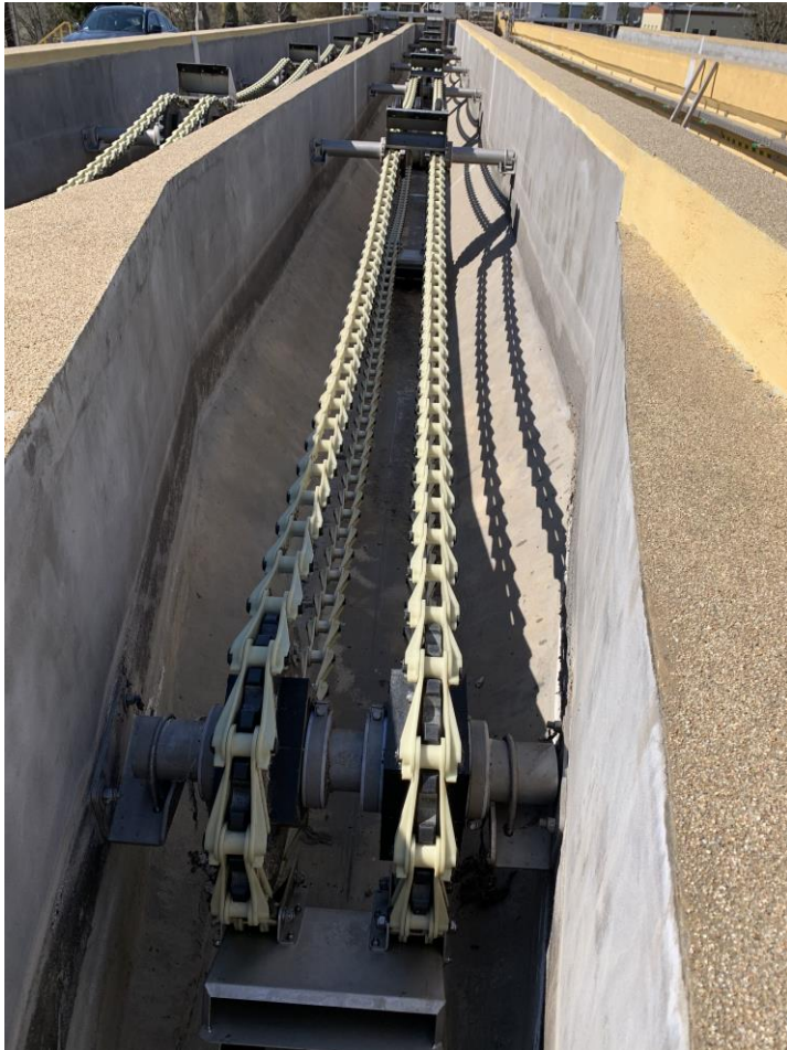
Oczyszczalnia Ścieków Katowice Panewniki
