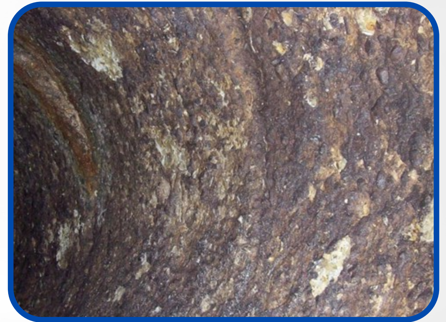
Widok wnętrza degradowanego kanału
