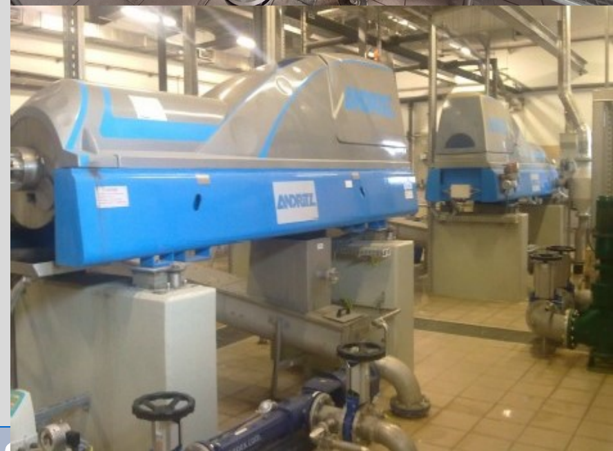
Budynek odwadniania osadu
