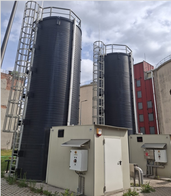
Odsiarczalnica biologiczna biogazu
