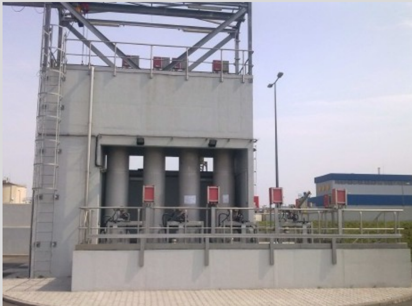
Pompownia osadu recykulowanego i nadmiernego
