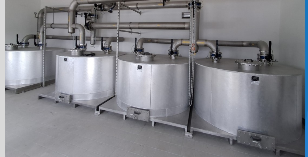
Stacja usuwania siloksanów
