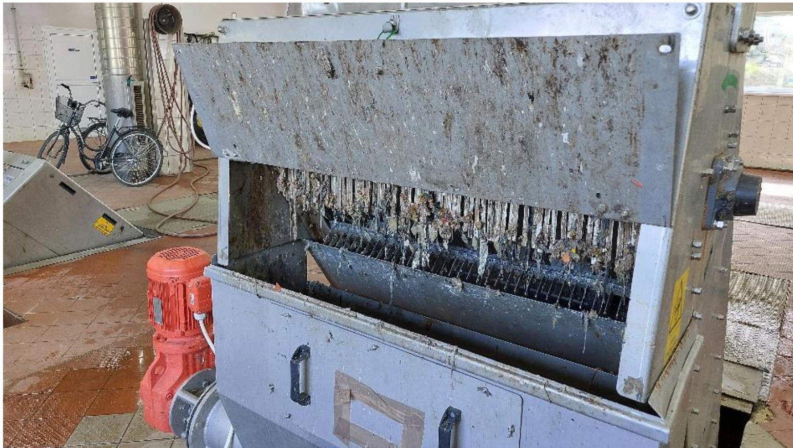
Płuczka skratek surowych w hali krat na oczyszczalni ścieków w Bolesławcu – 04-04-2024
