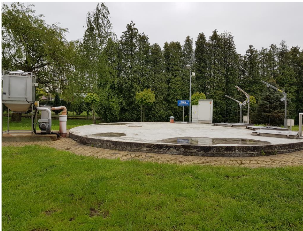
Zbiornik ścieków dowożonych z OŚ Komorowice
